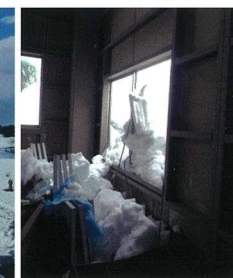
倉庫のガラス破損
